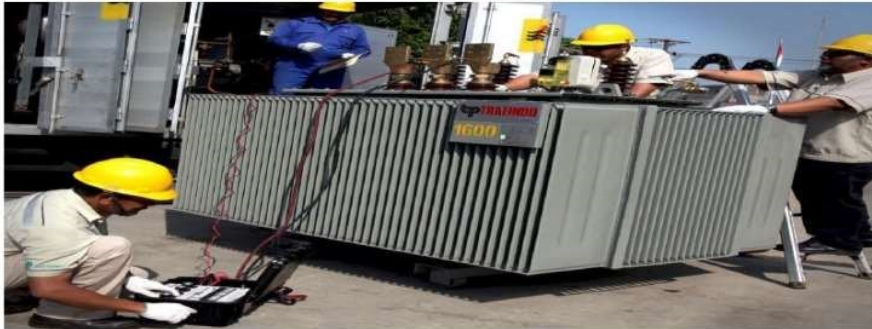
Gambar 4. 4 housing transformator oli standar
