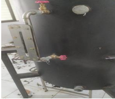
Gambar 1. 1 Failure pada Boiler
