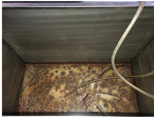
Gambar 1. 1 Korosi Pada Mesin Distilasi
